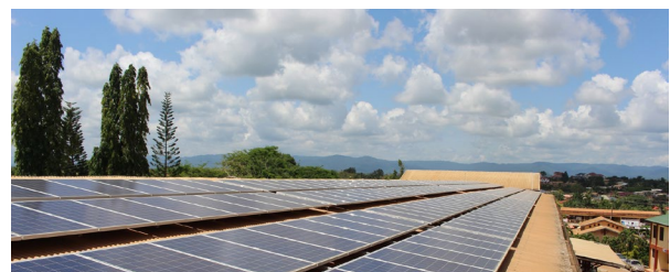
Installierte PV Module, St. Dominic's Hospital Akwatia, Ghana.
